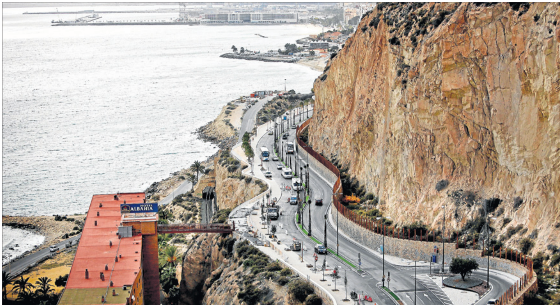
Detalle del talud de la Serra Grossa frente a la parte de atrás del hotel Albahía, con la carretera de la cantera en medio, una de la zonas más fracturadas. PILAR CORTÉS
